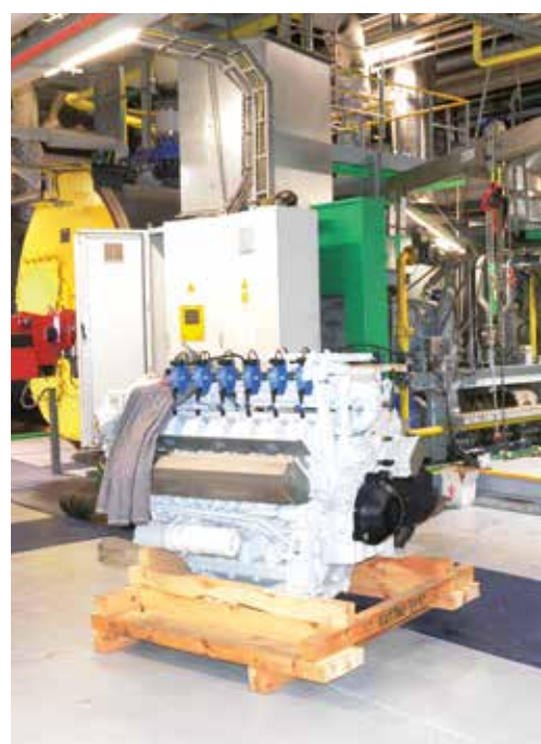
Warmtekrachtkoppelingssysteem in de hoofdzetel van D'Ieteren.
